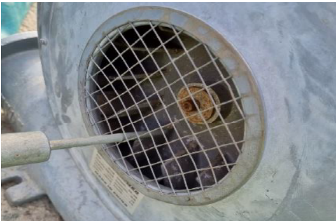
Fläkt där fingersond når in till rörliga delar.
